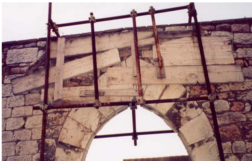
Cliché 1.4. La dégradation du patrimoine urbain à Assise.
