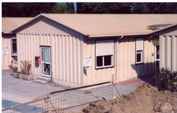
Cliché 1.11. Les préfabriqués à Assise après le séisme de 1997.
