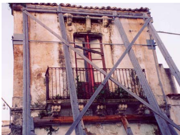
Cliché 1.12. Une habitation en état de dégradation avancée à Noto Alta.
