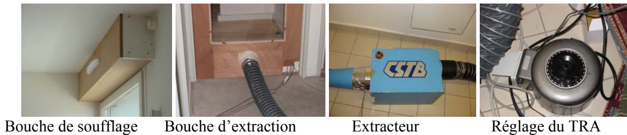
Figure IV-2 : Gestion de l'entrée et de la sortie de l'air dans la pièce
