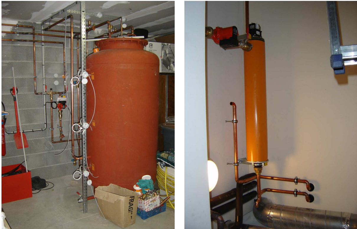
Figure 4. 20 : Ballon de stockage avant son isolation et la batterie électrique pour la régénération.
