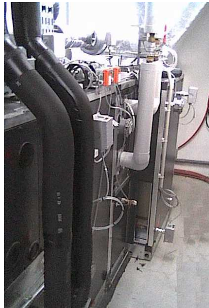
Figure 4. 7 : Vue de la centrale équipée des sondes et placée dans le local technique derrière la salle stage.
