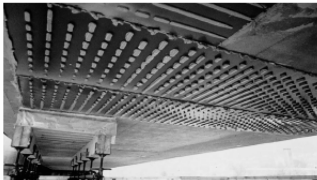
Figure Erreur ! Il n'y a pas de texte répondant à ce style dans ce document.-8 : Renforcement d'un viaduc par tôles collées
