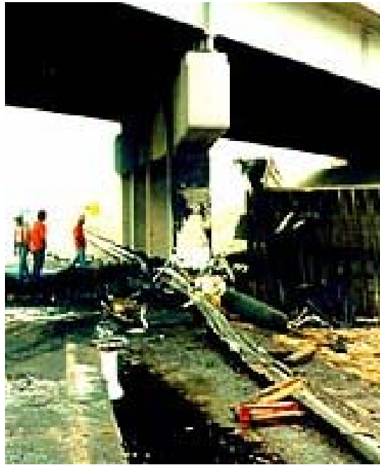
Figure Erreur ! Il n'y a pas de texte répondant à ce style dans ce document.-4: Choc sur un pile de pont
