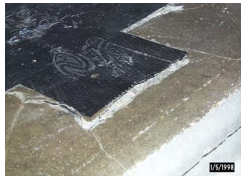
b) décollement du renfort avec le béton d'enrobage
