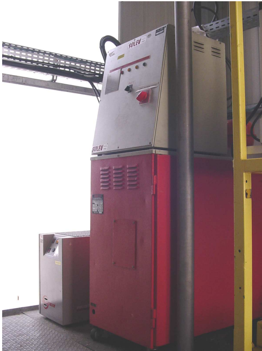
Figure D-4 : Chaudières CH301 et CH201.
