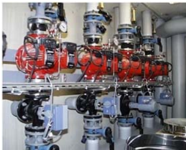
Figure 32 : vannes régulant les températures simulées sur le banc d'essais semi virtuel
