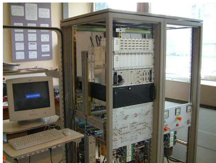
Figure 4-8 : Baie d'électronique de puissance
