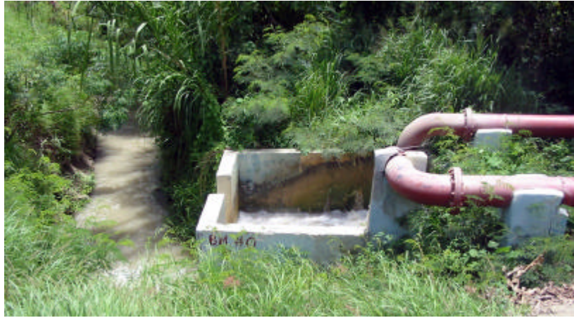
Photo 4 : pour irriguer les parcelles situées dans le cône alluvial de la vallée du Yaqué del Sur, l'eau est pompée dans le fleuve avant de s'écouler de manière gravitaire dans le reste du réseau.
