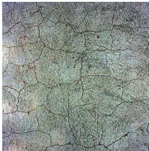
FIG. I.17: Fissuration précoce d'une dalle de béton soumis au séchage au très jeune âge.
