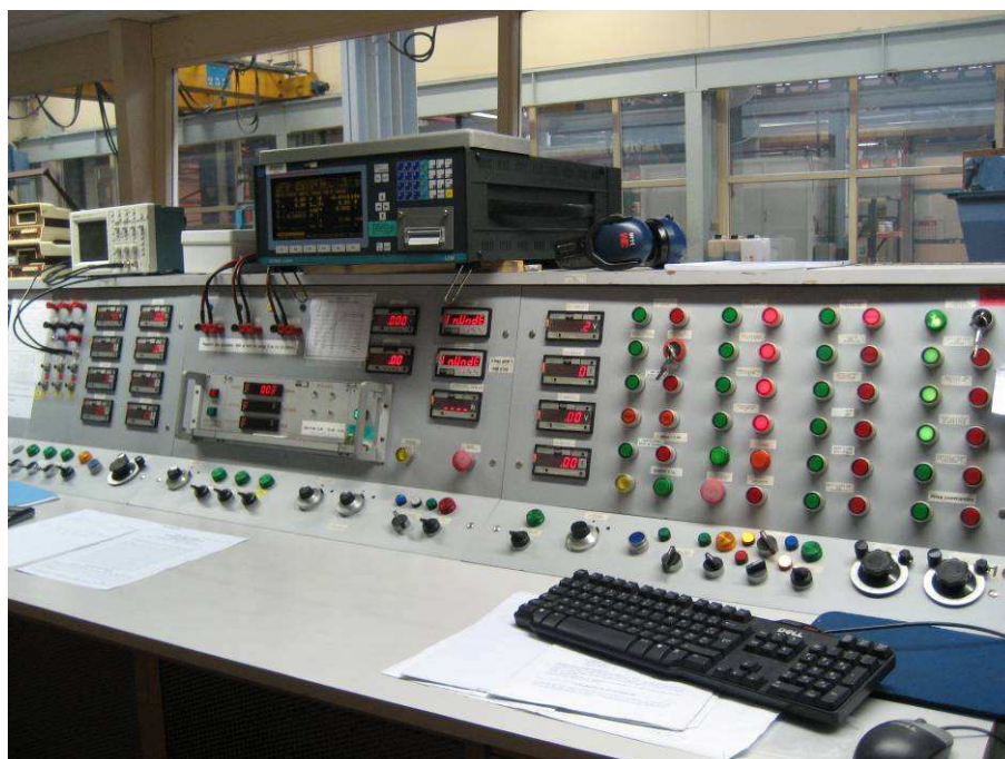
Figure 3 Panneau de commande du banc d'essais
