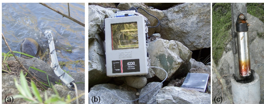
FIG. 4.4 – Exemples de stations limnimétriques installées provisoirement pour les chasses. (a) Emplacement d'un capillaire à proximité des enrochements pour (b) une station de mesure limnimétrique bulle à bulle ISCO 4230. (c) Capteur DIVER avant mise en place dans un tube métallique crépiné (diamètre du tube \approx 10 cm). Photo©B. Camenen.
