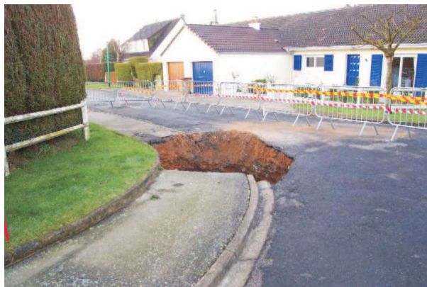
FIG. 1.2: Exemple de cavité effondrée à Bihorel, France
