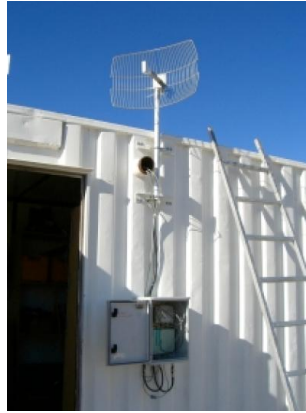
FIG. 6.22 – Vue du boîtier d’acquisition central fixé sur le bâtiment du CLF. L’antenne WiFi est dirigée vers les 3 stations situées à moins d’1 km. A l’intérieur du boîtier, le PC central et l’émetteur/récepteur WiFi. L’alimentation et la connexion internet sont prises à l’intérieur du bâtiment.
