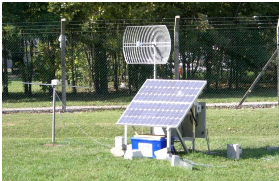
FIG. 6.19 – Vue d'une station assemblée au LPSC. A gauche, l'un des 2 dipôles de mesure. Au-dessus des panneaux solaires, l'antenne de transmission/réception des données vers le central. Au dos des panneaux solaires, le boîtiers d'électronique et le boîtier d'alimentation. Enfin, sous les panneaux solaires, le boîtier bleu contient les 2 batteries.
