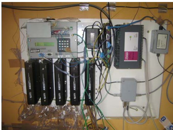
Figure 150 : Centrale d'acquisition et module d'alimentation
