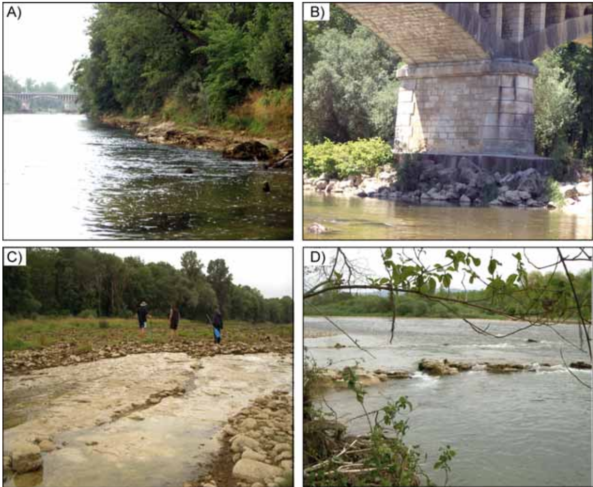
Photographie 2.1 : (A, C et D) Exhumation de blocs calcaires et du substratum par l'incision entre Varambon et Priay et (B) illustration des travaux de réfection réalisés au droit du pont de Priay. Nous observons que les fondations de l'ouvrage ont été affouillées d'environ 1,5 mètres à la suite de l'incision du chenal (clichés J. Lejot et personnels)
