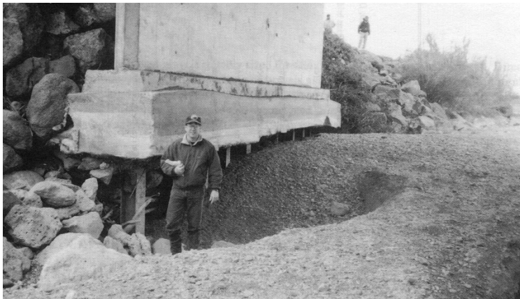
Photographie 4.1 - Affouillement de la pile du pont autoroutier 32 surplombant Stony Creek (Californie) (cliché de Kondolf, mai 1990). L'incision du lit (de l'ordre de 5 mètres) a nécessité des travaux de réparations dont le coût a été estimé à plus de 1,5 millions de dollars (Kondolf et Matthews, 1993)
