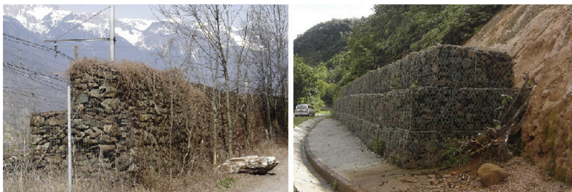
FIG. 1.4 – Ouvrages pare-blocs constitués de cellules mono-matériau (Sainte Marie de Cuines (73), Route de la grande traversée (97)).
