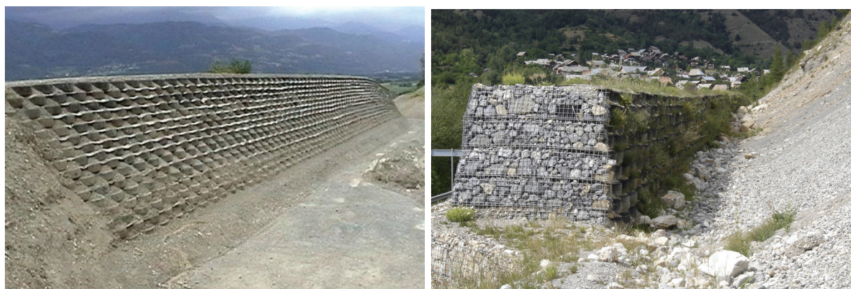
FIG. 1.3 – Merlons pare-blocs de Lumbin (38) et de Saint Martin de Queyrières (05), décrits au tableau 1.1.
