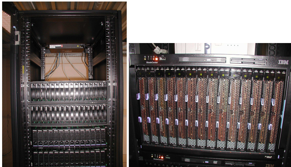
Fig. 1.11: Serveurs de stockage (à gauche) et de calcul (à droite) au LPNHE.
