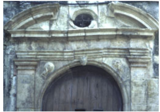
Figure 41 : Détermination d'un objet dégradé, le cas de l'oculus de la place des comtes de Provence, Brignoles, Var
