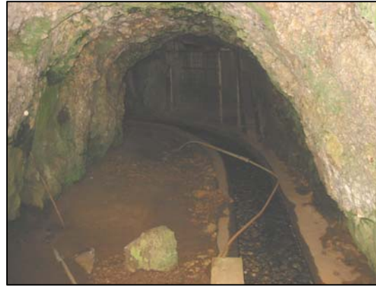
Photo 5.12. La canalisation pour le drainage de l'eau dans la grotte de Nabaa al-Mghara.
