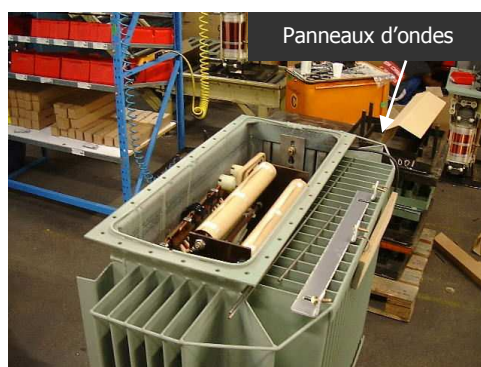
Figure 38. Cuve de transformateur équipée des panneaux d'ondes
