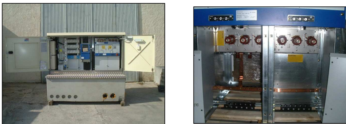
Figure 42. Photographies du PSSB et de la cellule HTA
