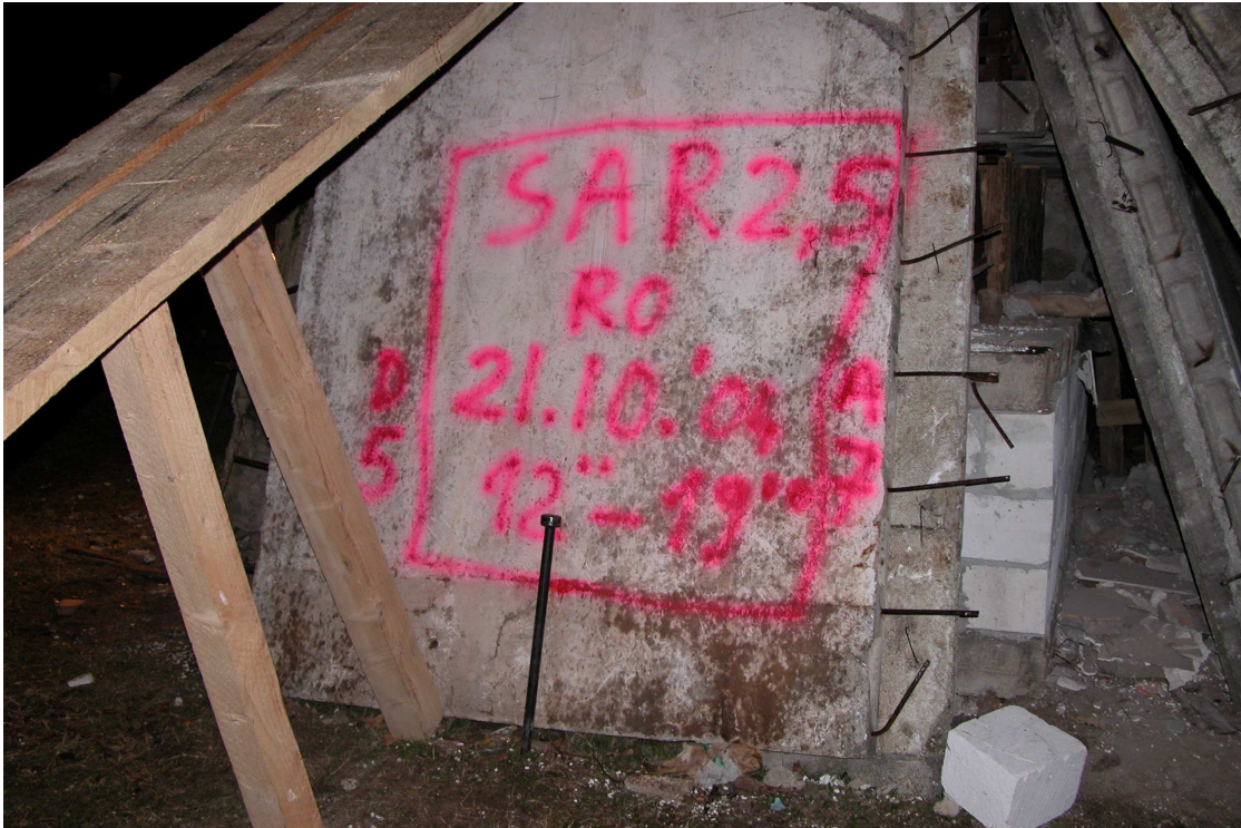
Abbildung 3.2: Mit Sprühdosen aufgebrauchte Angaben zu Schäden nach Einsturz eines Gebäudes. Bild von der Arbeitsgruppe Disastermanagement-Tool des SFB 461, Bukarest 2004
