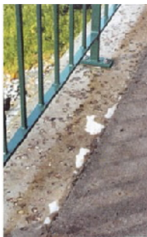
Figure 0.2 : Ecaillage sur des éléments de corniche (tiré de [81]).
