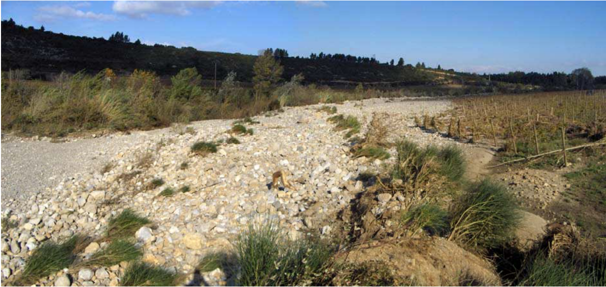
Photographie 4.9 : Digue arasée par la crue de la Berre le 15 novembre 2005
