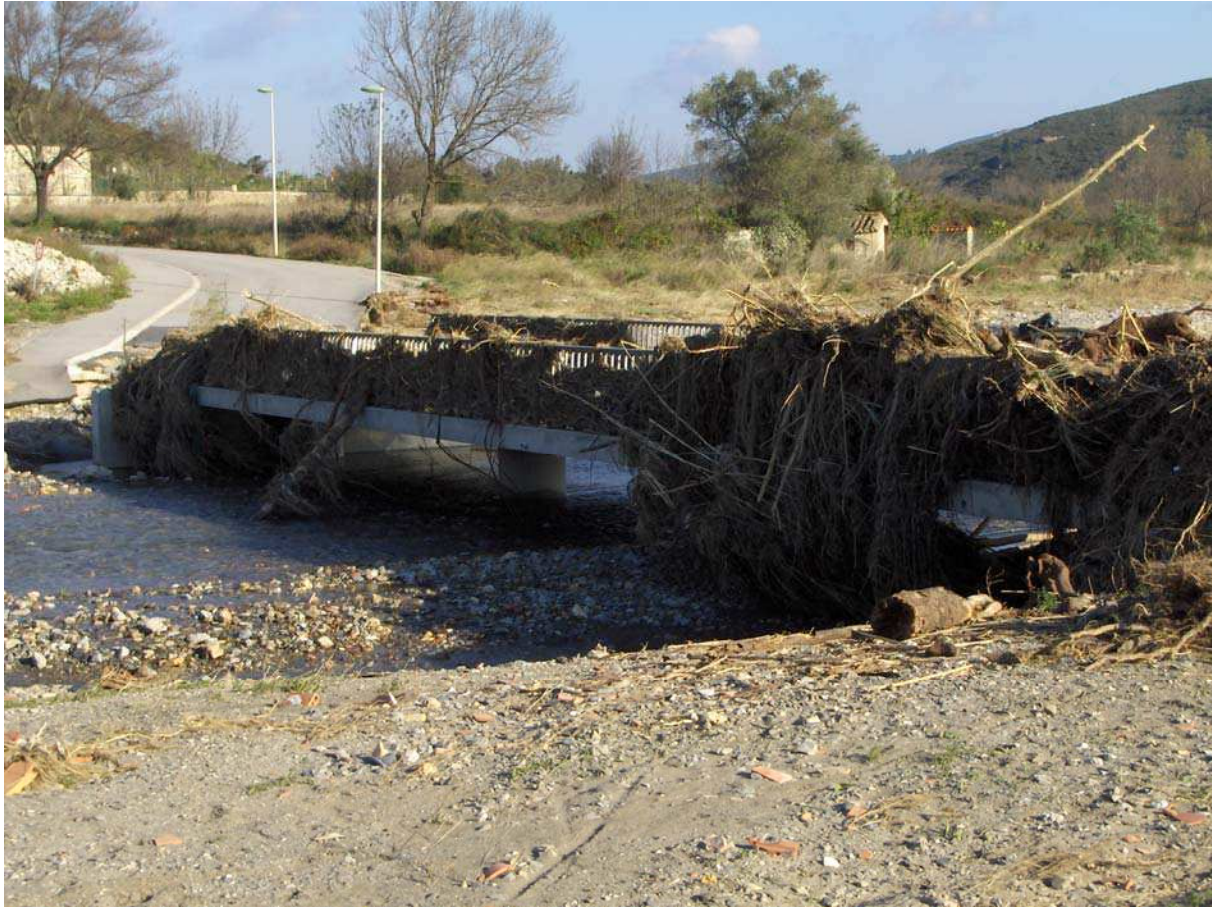
Photographie 4.6 : Le pont submersible à l'aval de Durban-Corbières, après les crues de novembre 2005
