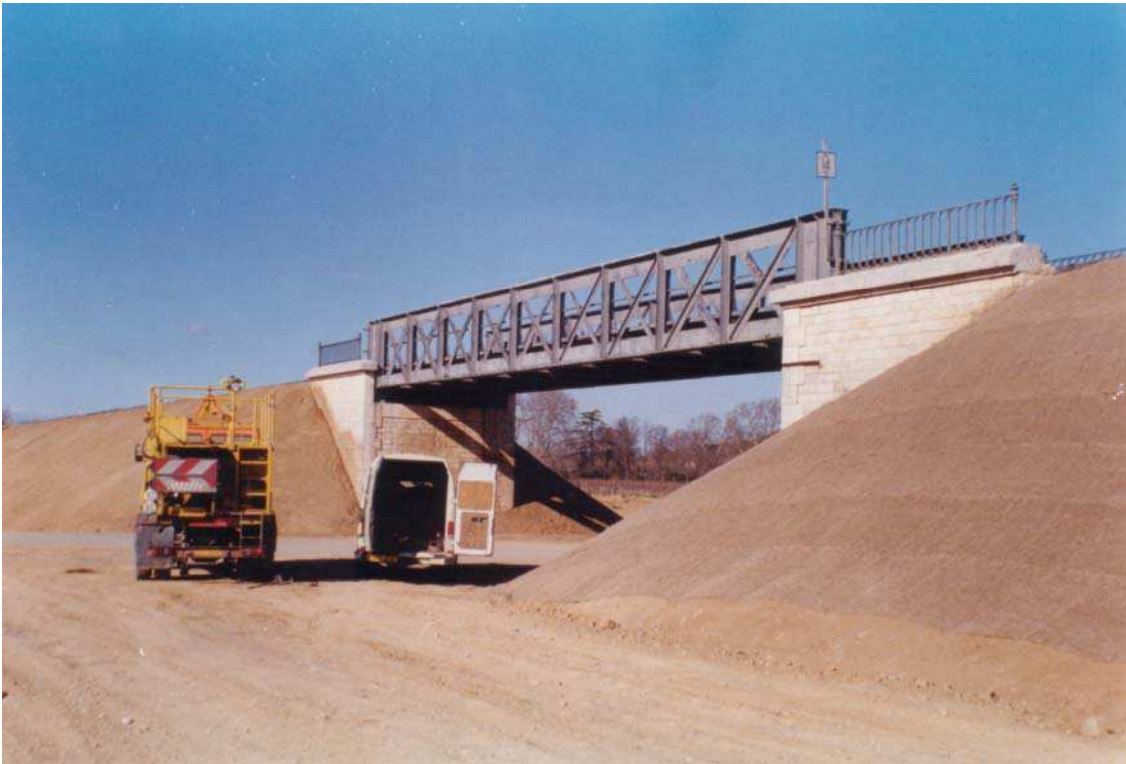
Photographie 4.5 : La transparence hydraulique à l'amont des basses plaines de l'Aude : reconstruction à l'identique du remblai de la voie ferrée Bize-Narbonne emporté par les crues de l'Aude en 1999 (cliché : M. Bonavida)
