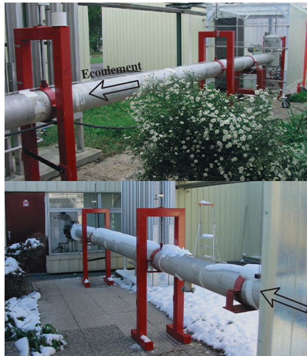
FIG. 4.4 – Vues du cryostat renfermant la ligne de mesure. Le sens de l'écoulement est indiqué. La photo du haut montre la partie amont de la ligne: on y distingue la boîte amont, où sont générés les écoulements diphasiques à partir d'un débit liquide, par application d'une puissance d'évaporation, ainsi que deux des piliers de maintien permettant le réglage de l'inclinaison de la ligne. Sur la photo du bas, on voit la partie située en aval de la portion de la ligne dédiée à l'établissement des conditions: la salle de mesures est située derrière la fenêtre, au fond de l'image.
