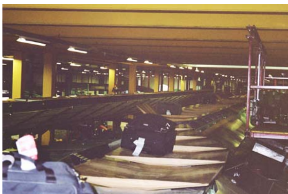
Figure 19 : Circuit de distribution des bagages, aéroport de Genève, 2003.
