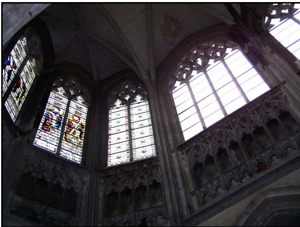
Figure 149 : Fenêtres hautes de l'abside de l'église Saint-Maclou avec leurs tirants.
