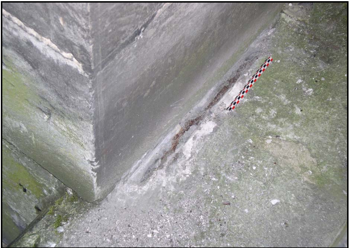
Figure 89 : Agrafes de la coursiue des fenêtres hautes du chœur de l'église Saint-Ouen de Rouen. En bas, agrafe longeant la maçonnerie de l'arc-boutant.
