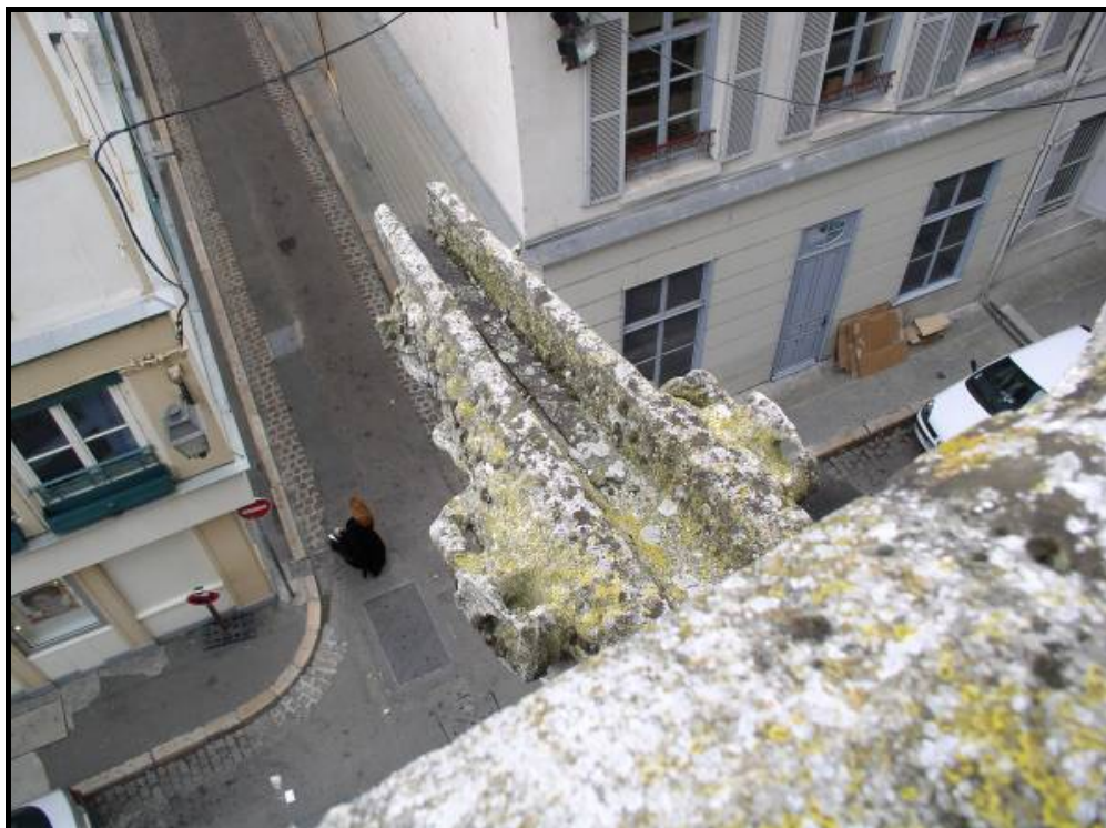
Figure 241 : Barre de fer dans une gargouille de la façade sud de l'église Saint-Jean au Marché.
