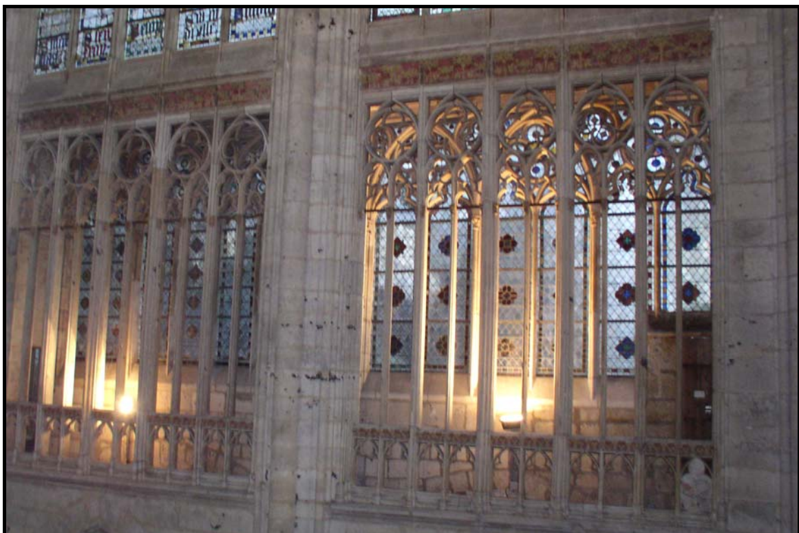
Figure 83 : Tirants en partie haute du remplage du triforium du transept
