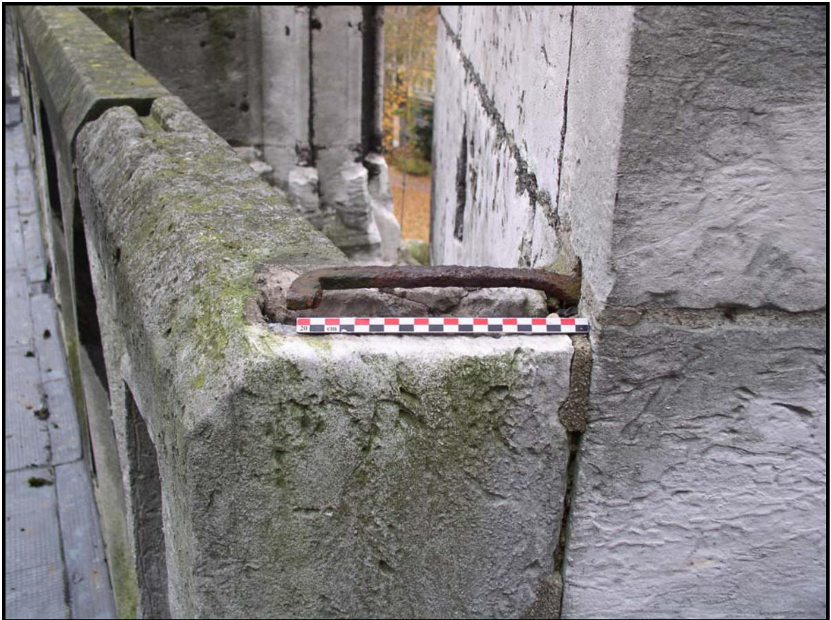
Figure 87 : Agrafes coupées ou tordues et logements d'agrafes vides suite à des restaurations au niveau de la balustrade extérieure du triforium du chœur.
