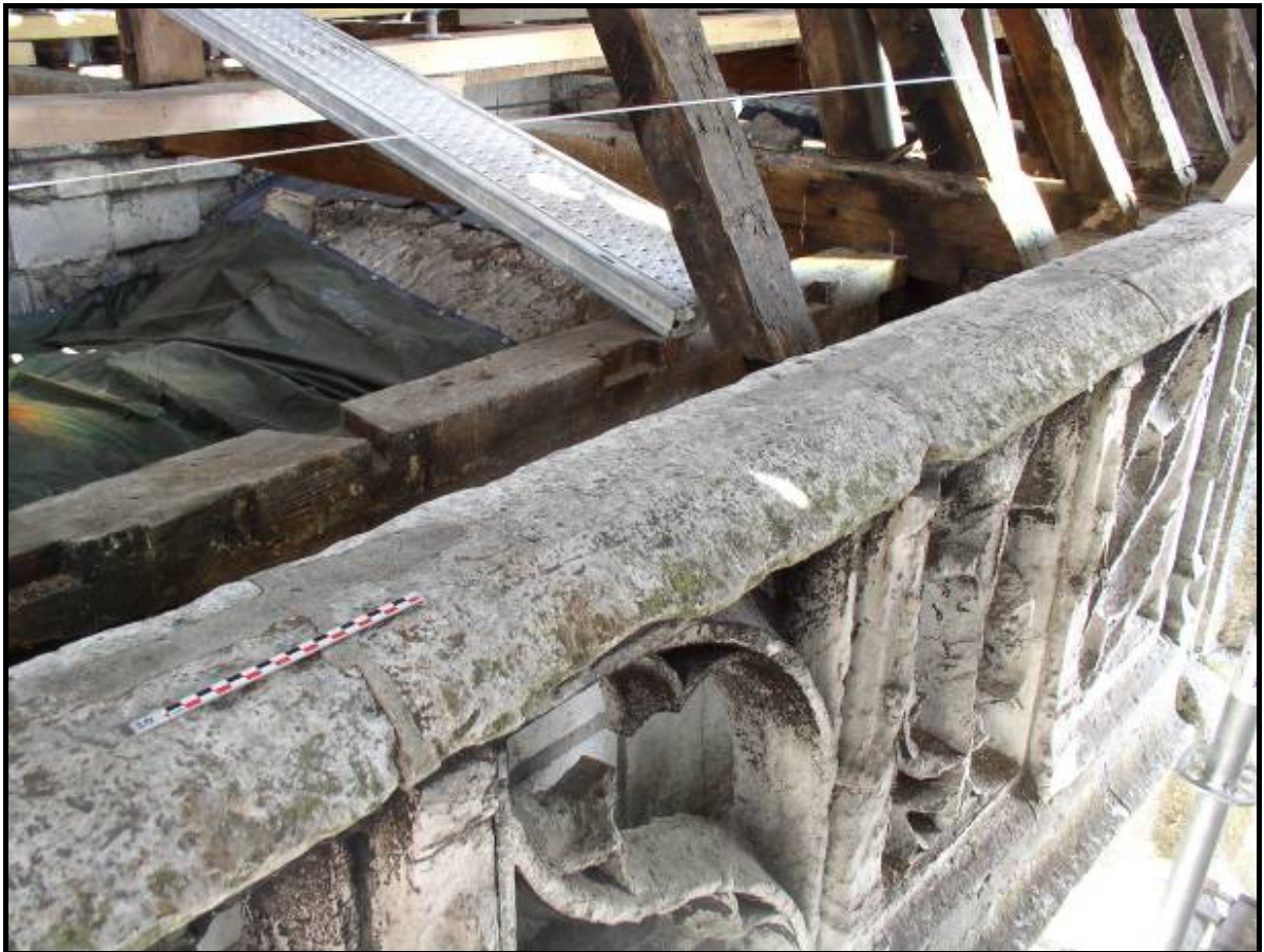
Figure 229 : Logements d'agrafes sur la balustrade des combles hauts du chœur de l'église Saint-Jean-au-Marché.
