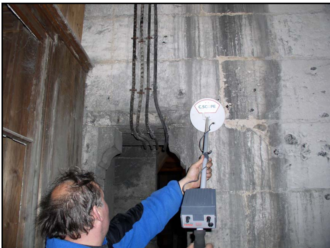
Figure 101 : Mise en évidence de la longueur d'ancrage des barres en linteau dans la maçonnerie par l'intermédiaire d'un détecteur de métaux, croisée du transept de l'église Saint-Ouen.
