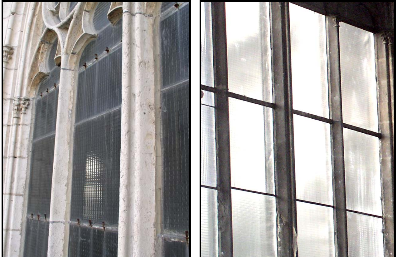
Figure 32 : Continuité du tirant haut prouvée par la discontinuité des meneaux (joint de plomb visible) et discontinuité du tirant bas prouvée par la continuité du meneau central, fenêtres hautes de la cathédrale de Rouen.
