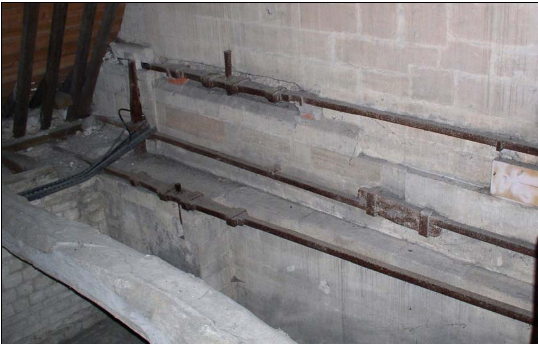
Figure 272 : Chaînages à la base de la tour-lanterne de la cathédrale de Bayeux.
