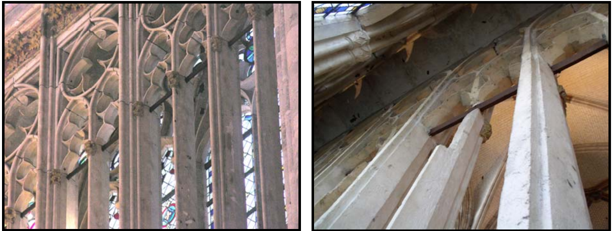
Figure 84 : Tirant en partie haute du triforium du chœur, clichés P. Benoit et M. L'Héritier.
