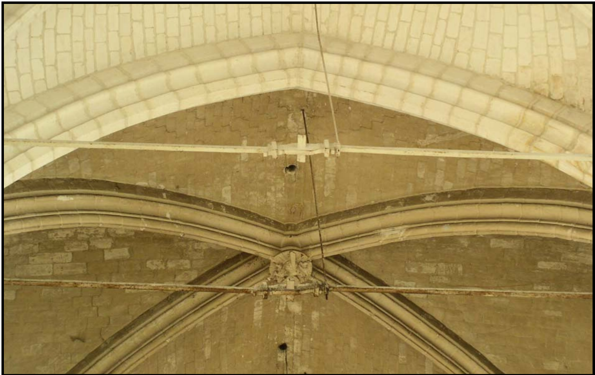
Figure 227 : Tirants dans la nef de l'église Saint-Jean-au-Marché. En haut à gauche, vue générale ; en haut à droite, ancre extérieure bloquant un tirant ; en bas, vue de l'assemblage des tirants.
