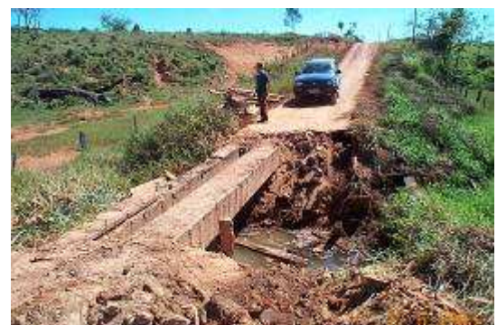
Photo 1.9 : un exemple du problème de l'entretien des ponts sur les pistes à Carlinda
