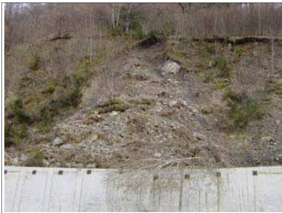
Figure 23 : Photographie d'un glissement de terrain superficiel par dessus le mur de soutènement.
