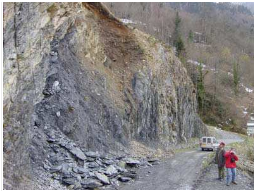
Figure 18 : Exemple de chutes de blocs de schistes du Carbonifère au-dessus de la route nationale 134, sur le chemin de Gouetsoule (Mai 2004).
