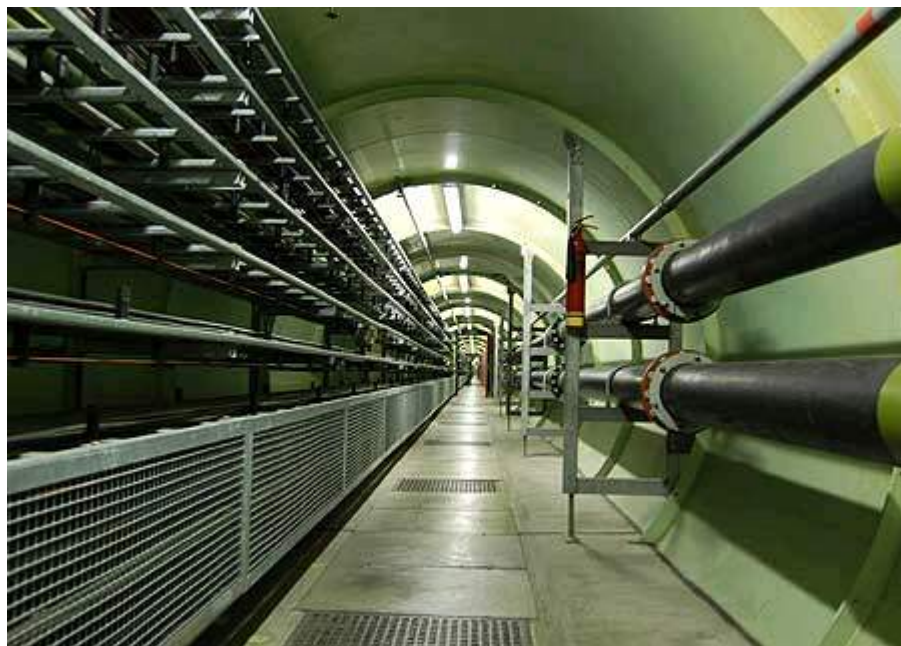
Figure A.4 : Le tunnel permettant de relier les différentes tours de contrôle (Source : BBC)
