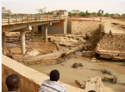
Destruction des ponts à Bandiagara
