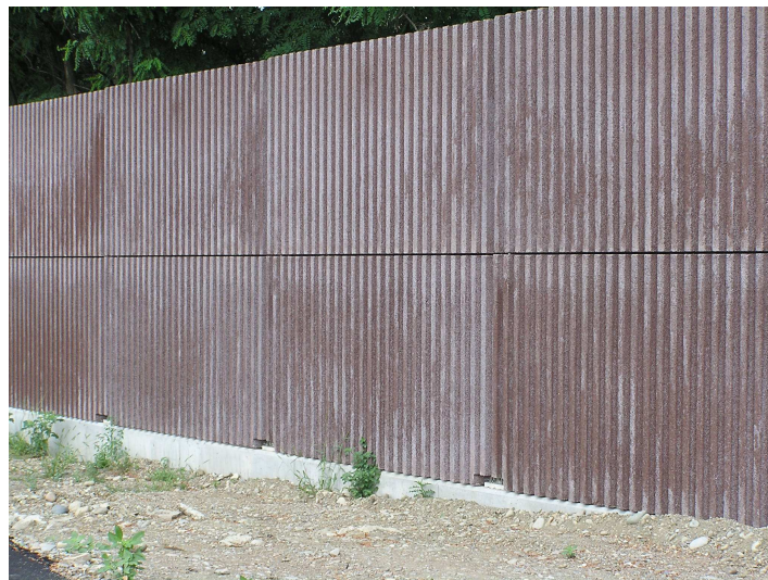
Figure A14.3 : Efflorescences sur bétons de bois, observées sur site
