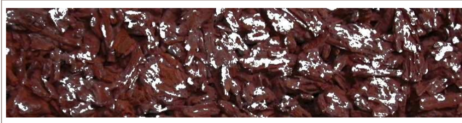
Figure A16.4 : Image avec zones présentant les efflorescences colorées en blanc
