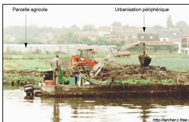
Photo 19 : Curage des canaux dans les hortillonnages à l'aide d'une pelle mécanique installée sur une barge.
