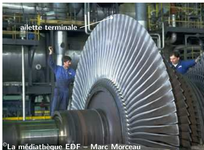
Figure 3 - Rotor de la centrale thermique classique de Porcheville (Yvelines)
