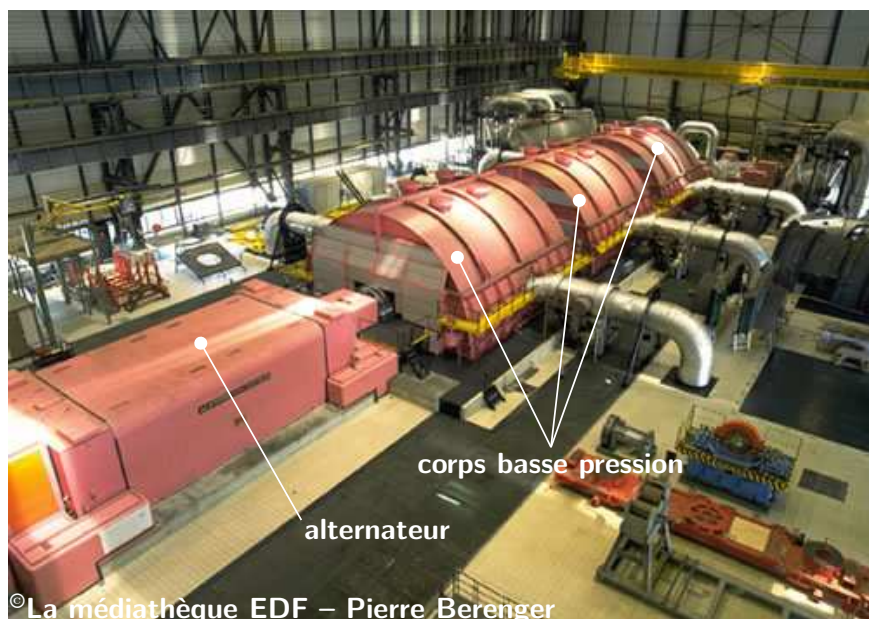
Figure 1 - Salle des machines de la centrale nucléaire de Flamanville (Manche)
