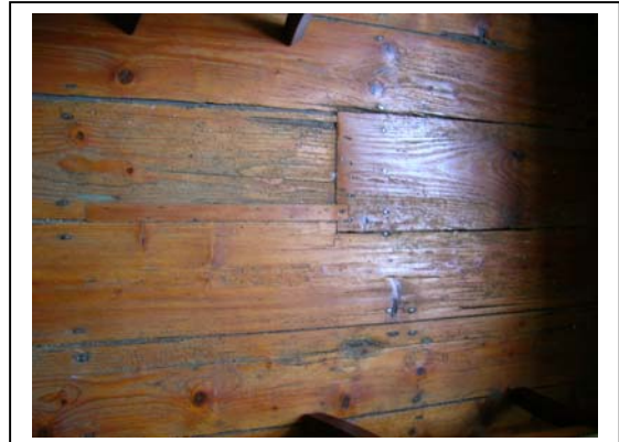
Planchers du N°15 rue Ferdinand Le Dressay, salon du 2 nd étage donnant sur le port. Fin XVIIIe siècle.
