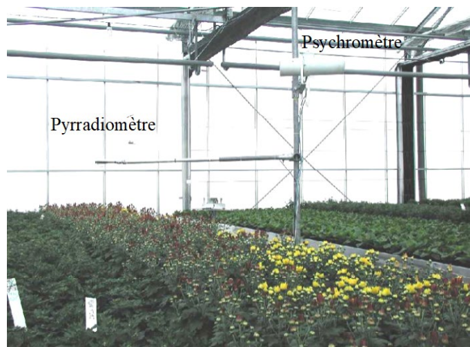
Figure 3.6. Capteurs de rayonnement, de température et d'humidité sur le mât intérieur
