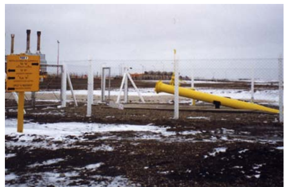
46... départ du gazoduc qui s'enfonce dans le sol
