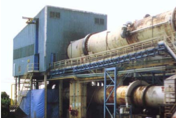
102.Les fours de Copetro, vue d'en bas
