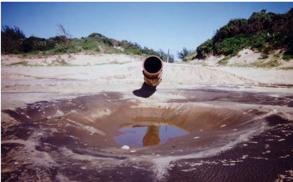
Photo 78 : La conduite après « l'éruption »
