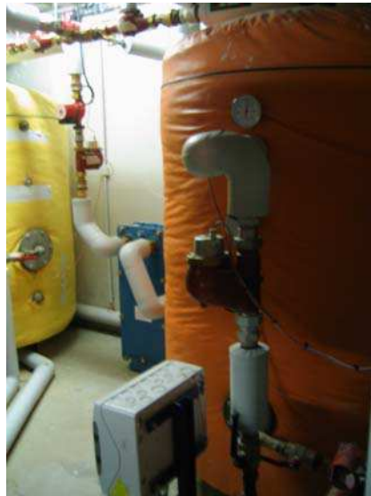
Figure 87 : Ballons de stockage
