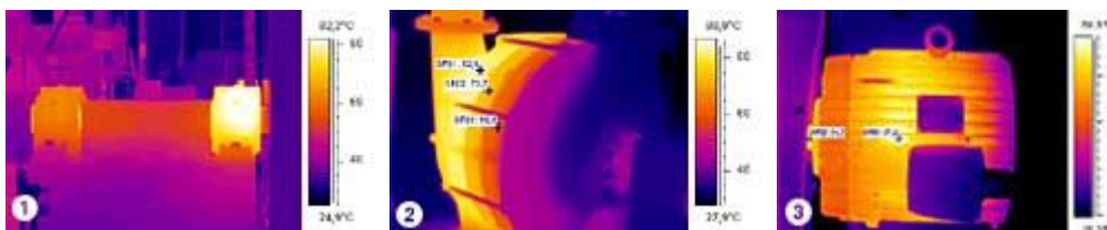
Figure.8 : Palier droit en surchauffe dû à un manque de graisse (1), Problème d'équilibrage sur un ventilateur (2), Echauffement d'un moteur (3)
