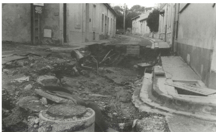
Figure 1.4 – Dégâts sur la chaussée et les réseaux souterrains, crue du 3 octobre 1988 à Nîmes. D'après Desbordes et al. (1989).
