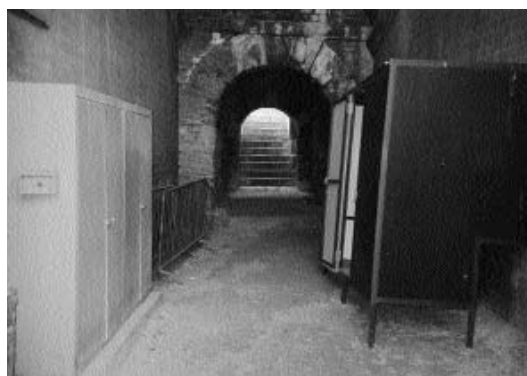
Fig. 407. Diverses installations techniques à l'amphithéâtre d'Arles: porte de fer dans une baie d'origine, ou armoires électriques sur un socle de béton dans une travée du rez-de-chaussée. (Phot. S. Delarue.)
