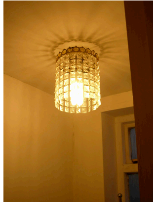
32. Luminaire, couloir du rez-de-chaussée, février 2006
