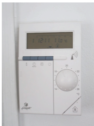
18. Thermostat, sur mur Sud, juillet 2005
