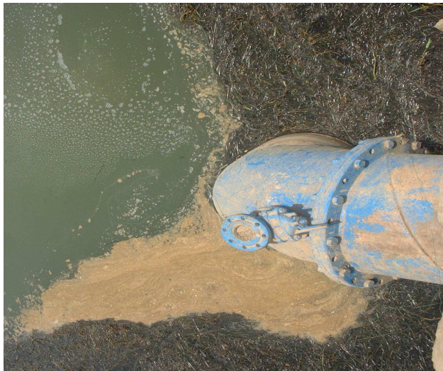
Photo 1 : Déversement d'eaux usées dans le fleuve par un canal de la CSS
