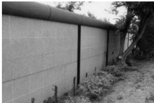
Figure 2.5 Écran avec couronnement cylindrique absorbant installé sur la RN 184 à Eragny
