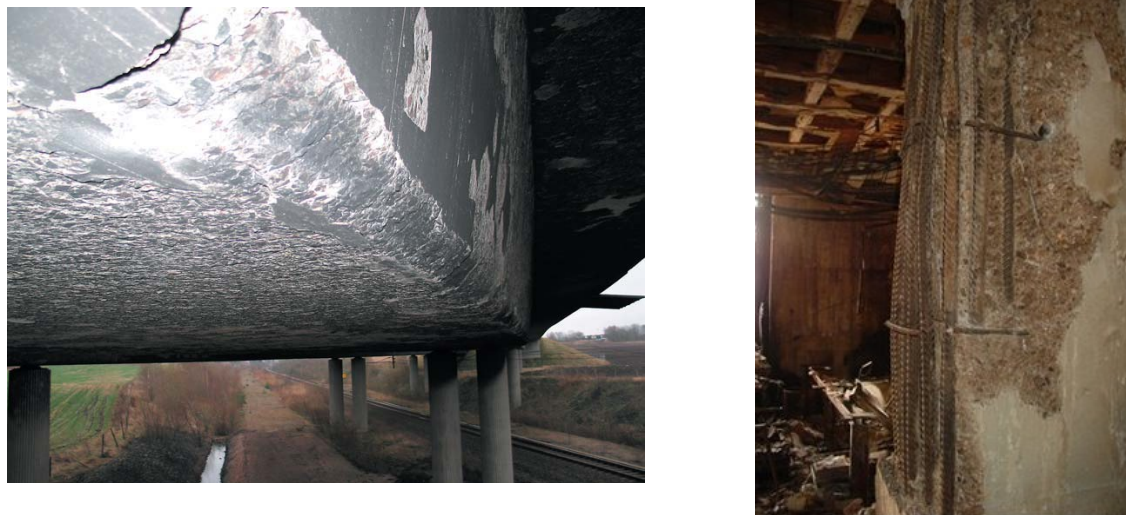
Figure 4 : à gauche, photo de l'éclatement d'un tablier de pont en Suède suite à l'incendie d'un camion citerne ( Bostrom and Lindqvist 2006 ). A droite, éclatement d'un poteau de la tour Windsor à Madrid suite à l'incendie de 2005.
