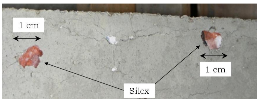
Figure 174 : cliché de petites zones de béton éjecté sur la dalle de B40SC_F2 attribuées à l'instabilité thermique des granulats silex proches de la surface exposée.
