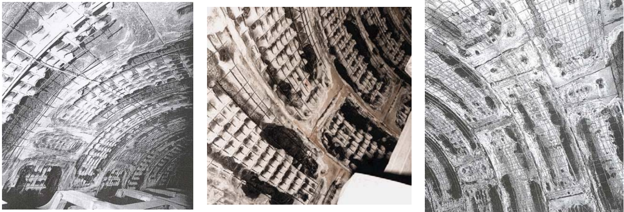
Figure 2 : photos des voussoirs du tunnel sous la Manche prises après l'incendie de 1996. Par endroits, l'épaisseur de béton des voussoirs a totalement été expulsée.
