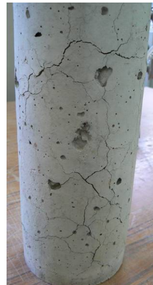
Figure 124 : cliché d'une éprouvette de B40SC à la suite d'un cycle de chauffage / refroidissement.
