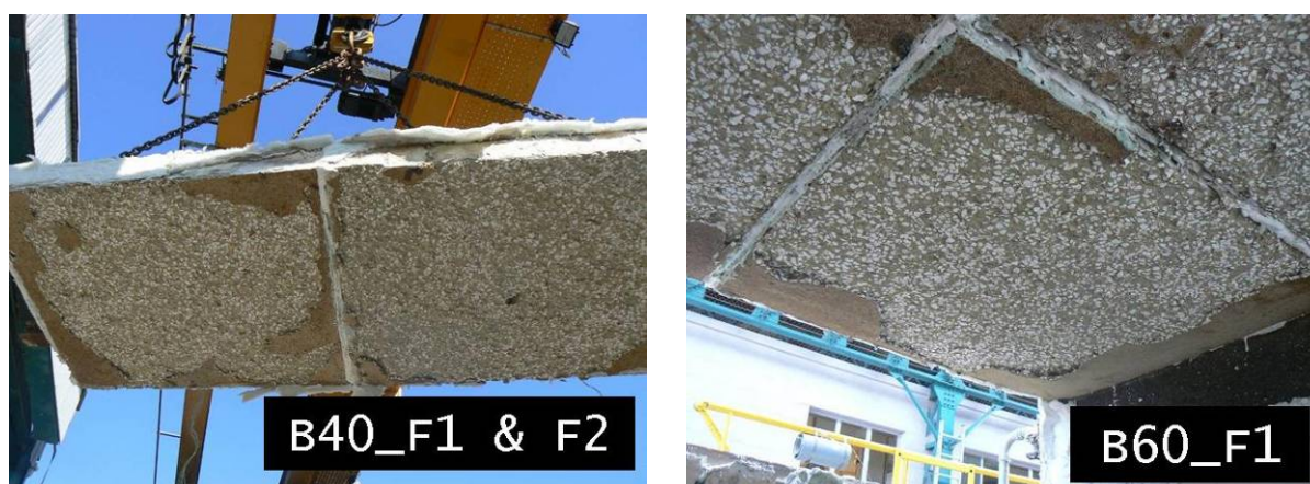
Figure 196 : clichés des faces exposées des dalles de béton fibré (B40F1 et F2 à gauche et B60F1 à droite) après l'essai HCM et refroidissement.
