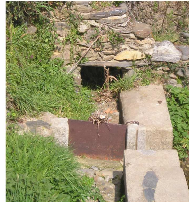
Ouvrage de transversement équipé de vanne sur un "petit canal" de Rigarda (cliché : Riaux, avril 2004)
