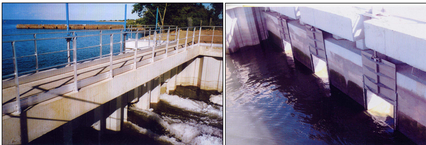
Photos 43 et 44 : barrage situé sur la digue séparant les prés salés du bassin interne. A marée haute, l'eau salée entre à travers quatre vannes indépendantes – ici, trois sont visibles et ouvertes – laissant apparaître des clapets qui s'abaissent sous son poids. Le niveau d'eau dans le bassin, lors de cette marée à fort coefficient, est supérieur à celui de la zone inondée. Le barrage peut être emprunté par les promeneurs (Clichés : M-F. Perrin, juin 2008).
