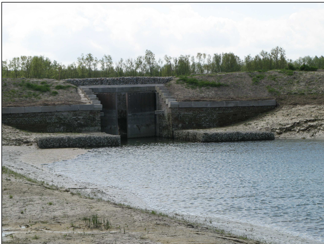
Photo 60 : un système de vannes, s'ouvrant et se fermant en fonction des marées - semblable à celui de l'écluse située à l'embouchure de la Maye au nord du Crotoy - permet au Dien de s'écouler dans les mollières de la baie de Somme. L'« habillage » de l'ouvrage a été fait en partie avec des matériaux locaux, comme les galets. (Cliché V. Bawedin, avril 2009).
