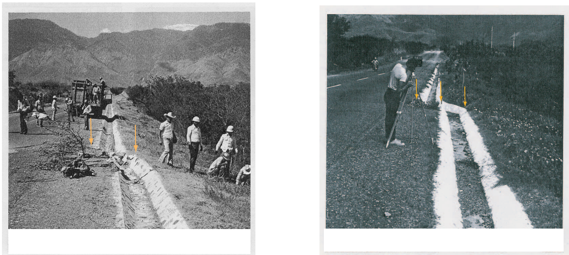
FIG. 2.12 – (à gauche) Vue vers le Nord de la route CA-10 près de Zacapa le 8 février 1976. De part et d'autre de la trace de faille, Bucknam et al. , (1978) observent un décalage latéral sénestre de 60 cm et un décalage vertical de 5 cm. (A droite) Vue du même site le 6 Octobre 1977, Bucknam et al. , (1978) observent que le glissement postsismique atteint 31 cm sur ce site entre le 8 février 1976 et le 6 octobre 1977. Les flèches oranges marquent la trace de rupture.
